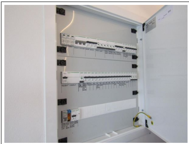
Bytový rozvaděč elektro
