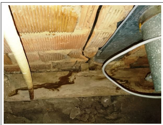
Zatékání do trámového stropu
