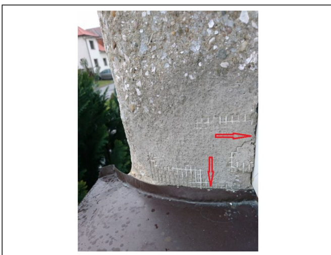
Netěsnosti v krycí konstrukci- oplechování venkovních parapetů
