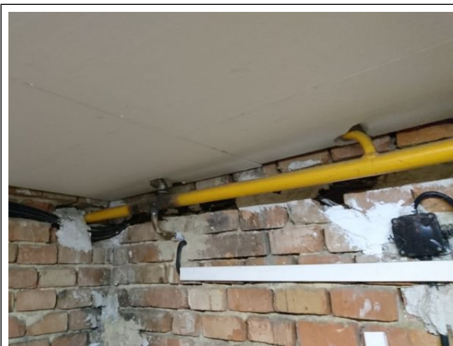
Korodující potrubí rozvodu plynu
