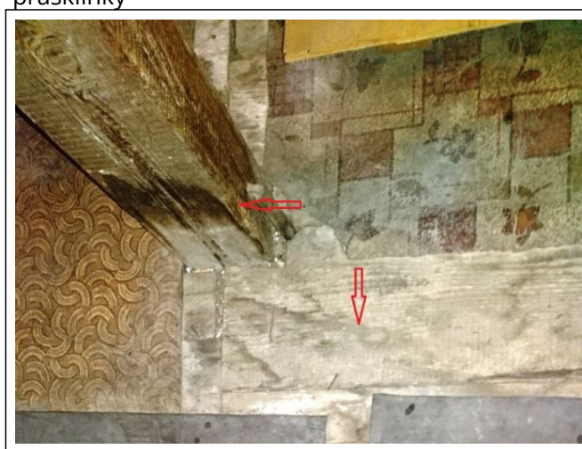
Stopy po zatékání na podlaze půdy
