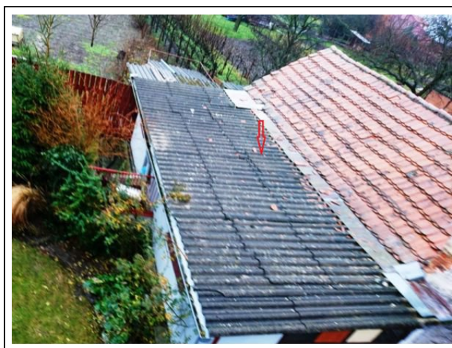
Střešní krytina s obsahem azbestu na střeše garáže
