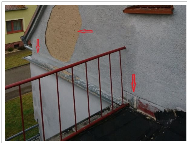
Netěsná krycí konstrukce ( krycí lišta šástečného zateplení štítové stěny
