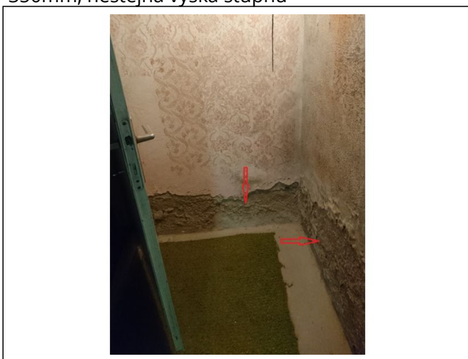
Vzlínající vlhkost do stěn ve sklepe
