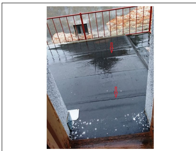
Nerovnosti v ploše terasy, degradovaná krytina
