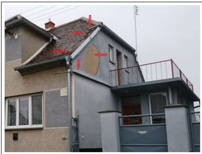
Zatékání do štít.stěny.
