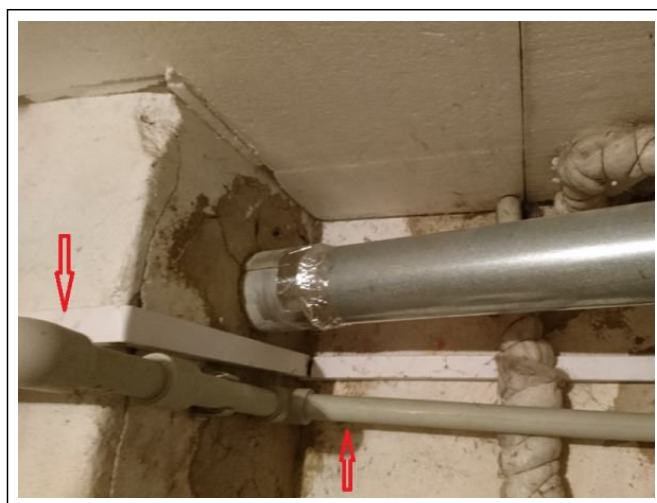
Plynový ohřívač-nezateplené rozvody vody
