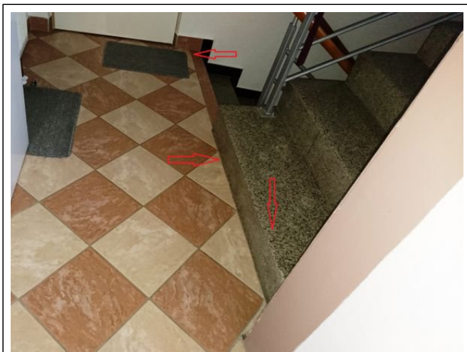
Vzdálenost zárubně a hrany schod. stupně pod 350mm, nestejná výška stupňů
