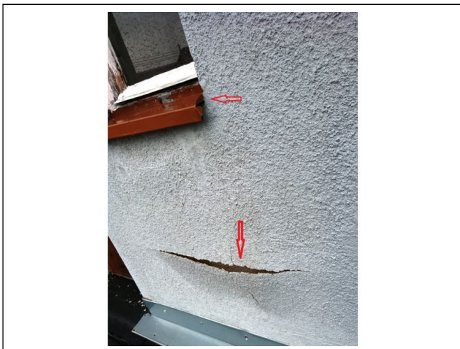
Degradovaná omítka - štítová stěna terasa
