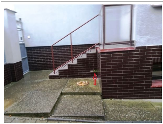
Odpadávání obkladu, nebezpečný stav zábradlí
