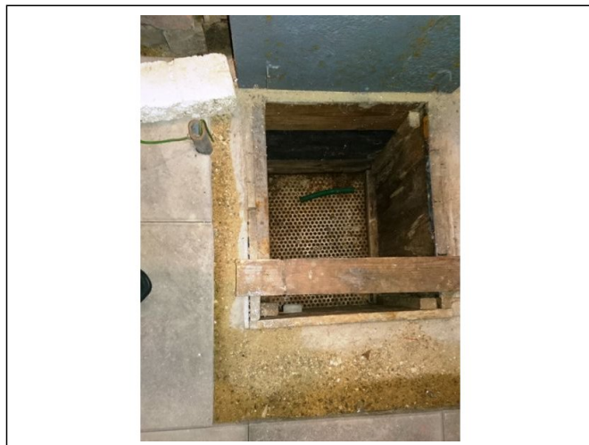
Šachta určená k odčerpávání vody ze sklepa napojená na kanalizaci
